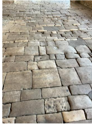
Sol des Halles très cabossé avec risque de chute
